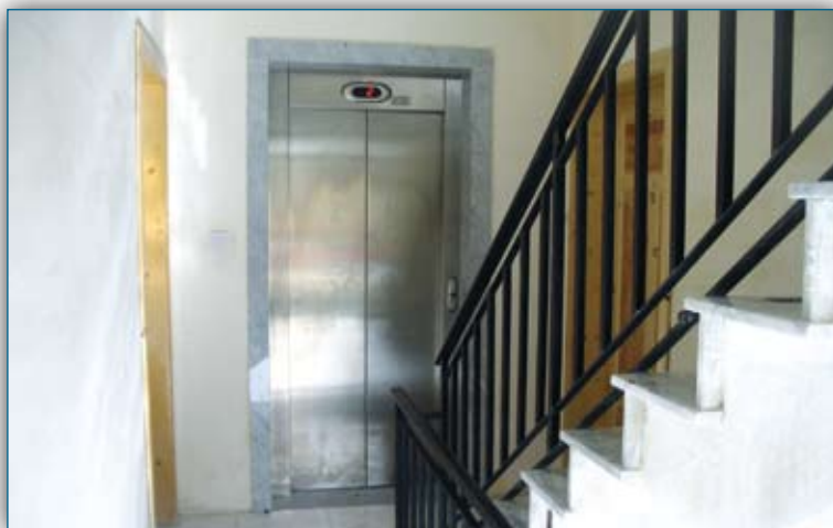
Lift fi blokka ta' appartamenti f' Birzebbuġia
